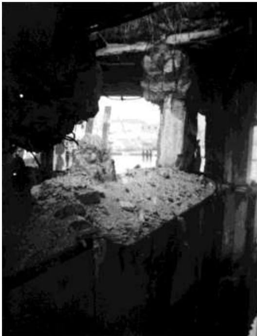
Tallboy ødelæggelse inde i den gamle motor- torpedobådsbunker i Ijmuiden selv om taget var blevet forstærket.
