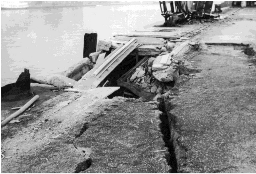
Bombeskader på kajanlæg foran bygning 112 på Germania Werft. (C. Petersen)
